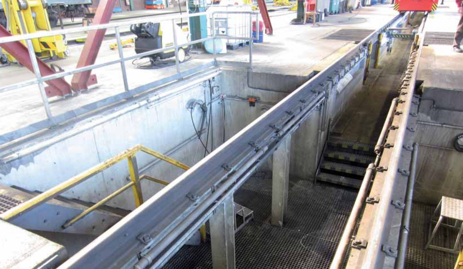
Unterflur-Waschstand zur Reinigung von Schienenfahrzeugen
