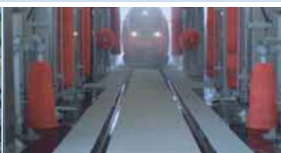
Auffangsystem für Außenreinigungsanlage
