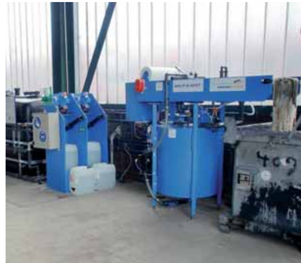
Abwasserbehandlungsanlage des Typs Split-O-Mat SOM 1100 zur Behandlung von Waschwässern aus der Schienenfahrzeugwartung.
