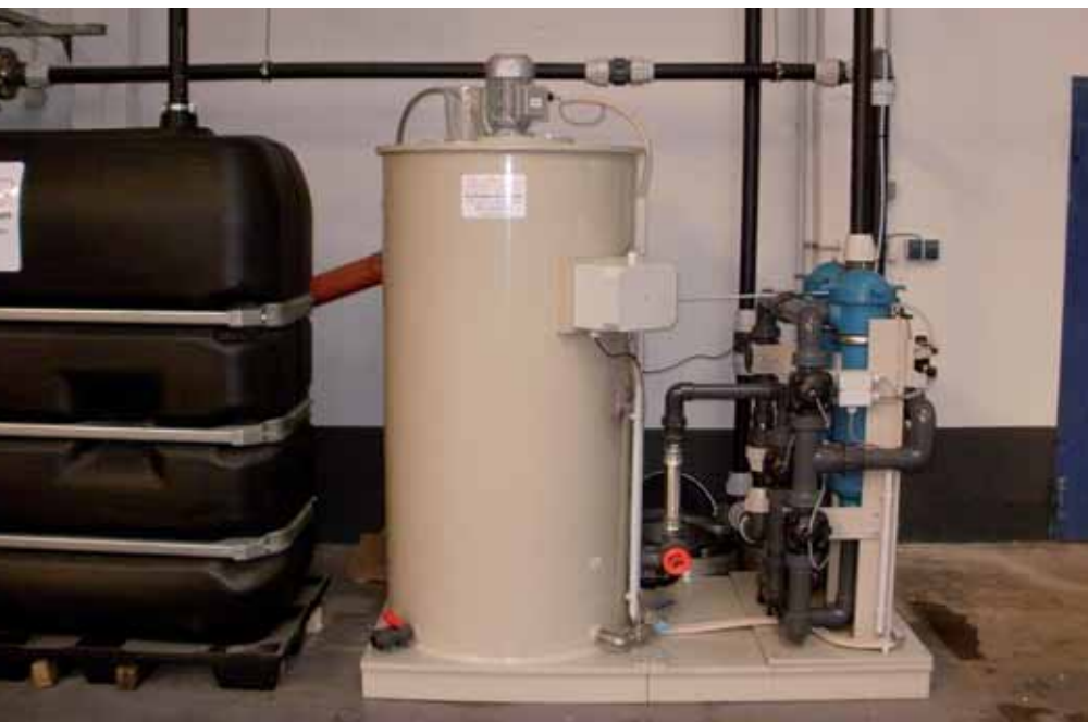
Kernstück des Gesamtkonzeptes stellt die im Kreislauf arbeitende Belüftungsstufe mit atmosphärischer Luftansaugung, Zyklondrall und automatisch rückgespülter Filtereinheit dar.
